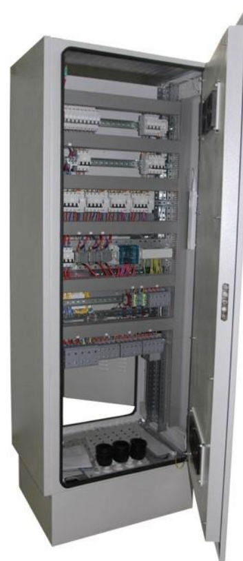
■ Шкаф управления освещением
